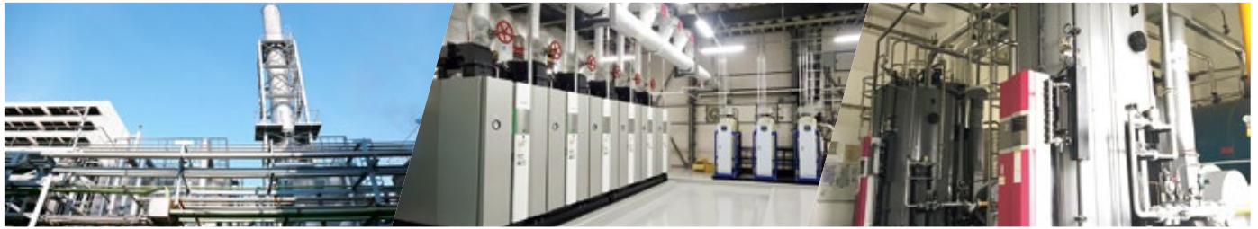
大塚化学：徳島工場コージェネレーションシステム
