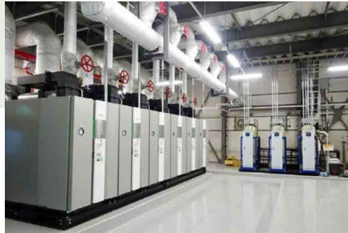
大塚製薬工場：富山工場のボイラー室
