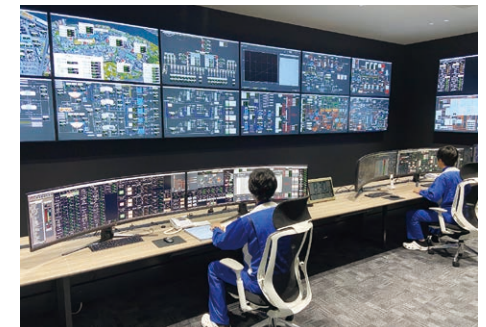
統合エネルギー管理の様子
