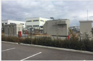
非常用自家発電設備
