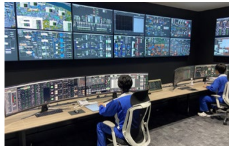
統合エネルギー管理の様子
