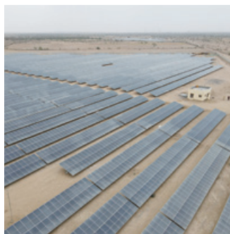
大塚ケミカルインドア 太陽光発電設備
